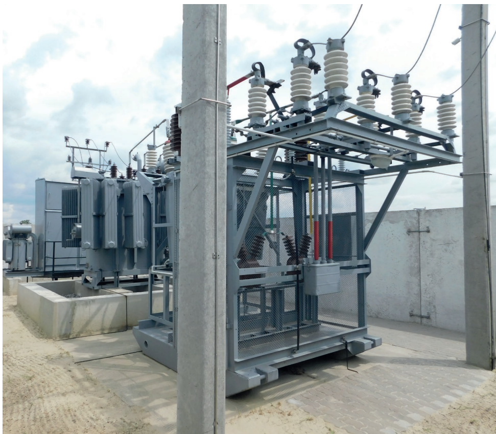
Нова підстанція «Молокозавод» у дії.
